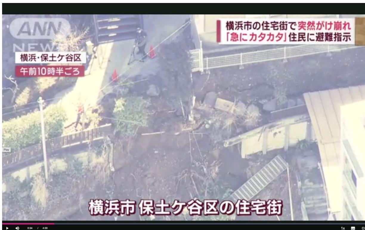
図 3. 崩落した斜面 (R5/2/11 テレビ朝日)。土砂がコンクリート柵板を損壊し、北側（下位）の敷地に崩れている。右側の崩壊していない部分の斜面に亀裂が見られる
