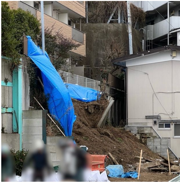
図 11. 土砂崩壊地点を側方（東）から撮影
