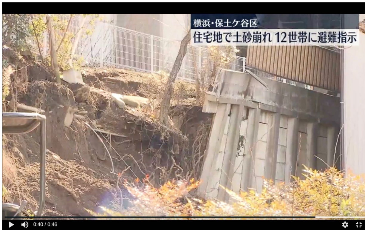
図 4. コンクリート柵板 (R5/2/11 日本海テレビ)。斜面には土砂災害の対策工が見られない。崩落した斜面には配管が認められ、盛り土であると考えられる
